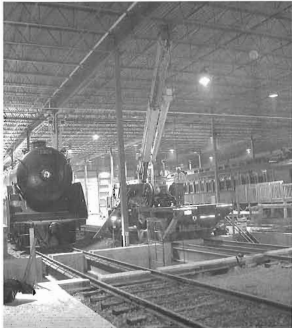
Mobile crane had to back down track 16 to gain access to the pit to lower the jack into place. (GH) La grue mobile a dû reculer le long de la voie 16 pour avoir accès à la fosse afin d'y déposer le cric. (GH)
